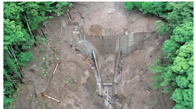
図-5 中流部の堰堤の堆砂状況
