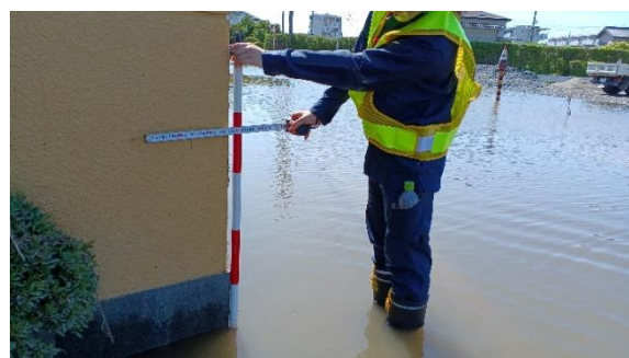
図-2 浸水痕跡調査
