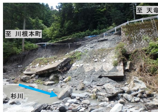
図-1 当初被災状況
