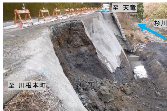
圖-3 床掘斜面崩壞狀況
