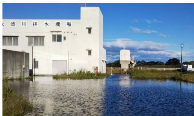
写真-1：令和元年東日本台風による浸水状況
