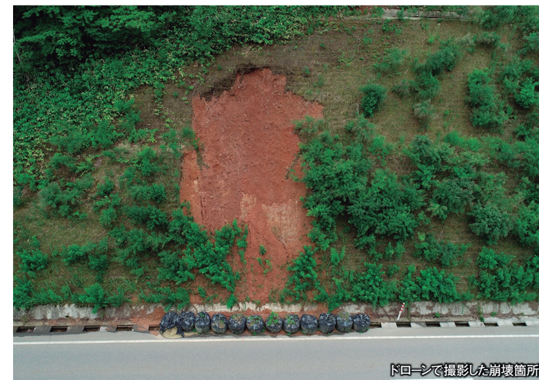
ドローンで撮影した崩壊箇所
