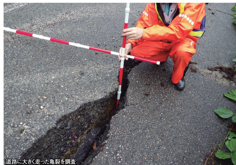
道路に大きく走った亀裂を調査
