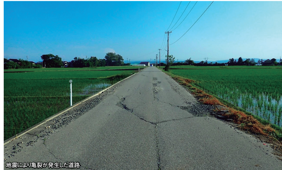
地震により亀裂が発生した道路
